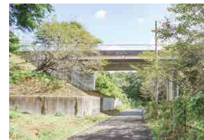
⑬ 橋梁 2つの丘の上につくられたキャンパスの敷地同士を、1つにつなぐ重要な橋梁。現在は公共バスの路線も担っているが、老朽化が進行している。
